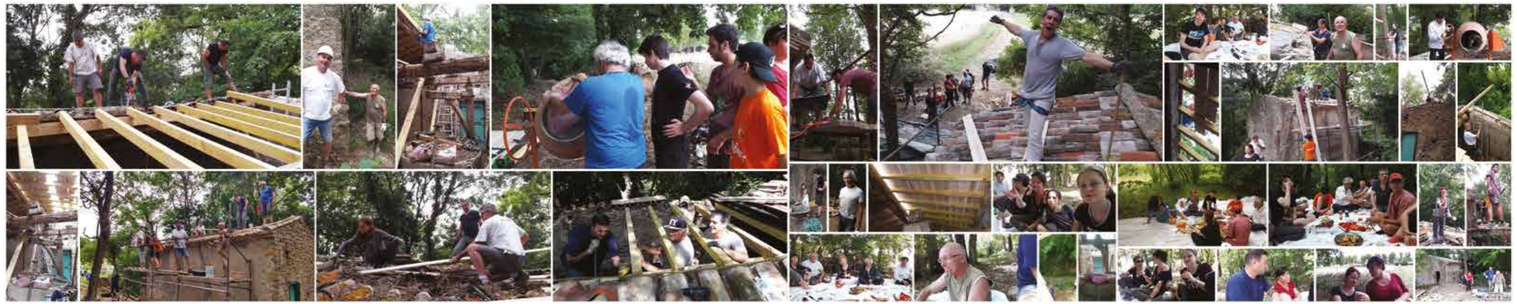
JUIN 2017 - Week-end épique de réfection du toit du moulin, renforcement de faitage, réfection des chevrons et des voliges. Poses de tuiles anciennes offertes par Jean-Claude
